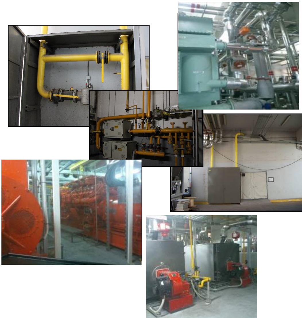
Εικόνα 13: Εγκαταστάσεις φυσικού αερίου στο Ενιαίο Εμπορικό & Επιχειρηματικό Συγκρότημα Golden Hall
