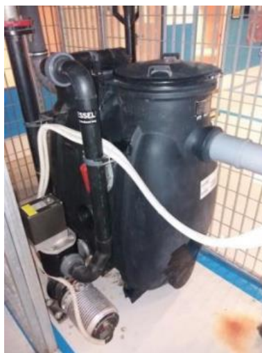
Εικόνα 12: Λιποσυλλέκτης για τη διοχέτευση των υγρών αποβλήτων στο Ενιαίο Εμπορικό & Επιχειρηματικό Συγκρότημα Golden Hall
