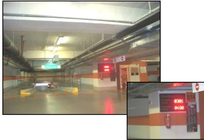
Εικόνα 16: «Έξυπνο» σύστημα διαχείρισης κυκλοφορίας στους υπόγειους χώρους στάθμευσης
