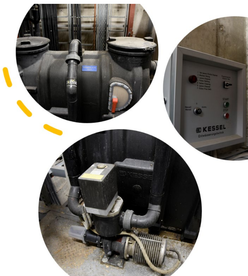
Εικόνα 9: Λιποσυλλέκτης για τη διοχέτευση των υγρών αποβλήτων στο Ενιαίο Εμπορικό & Επιχειρηματικό Συγκρότημα Golden Hall
