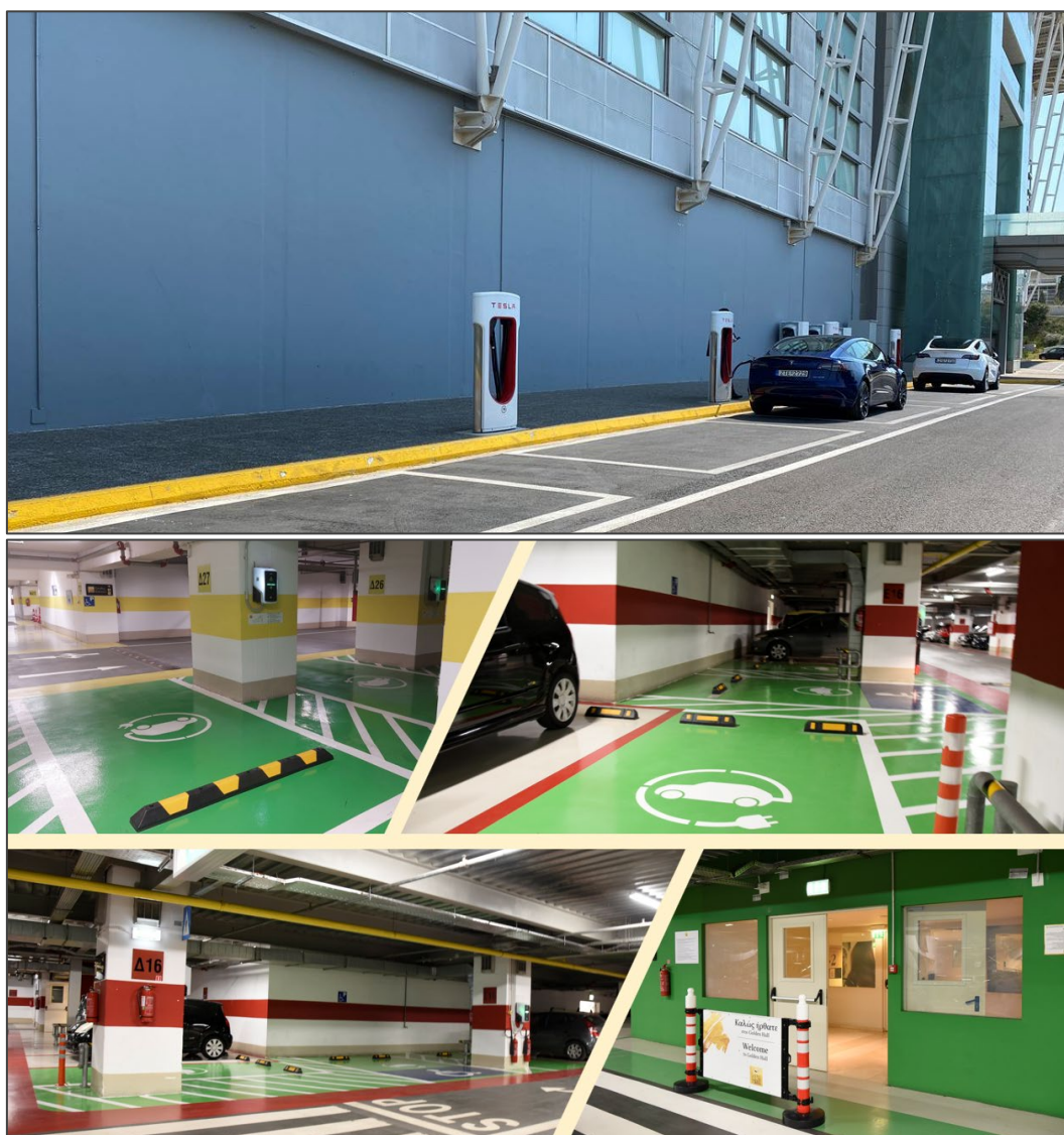
Εικόνα 14: Χώροι φόρτισης ηλεκτρικών αυτοκινήτων
