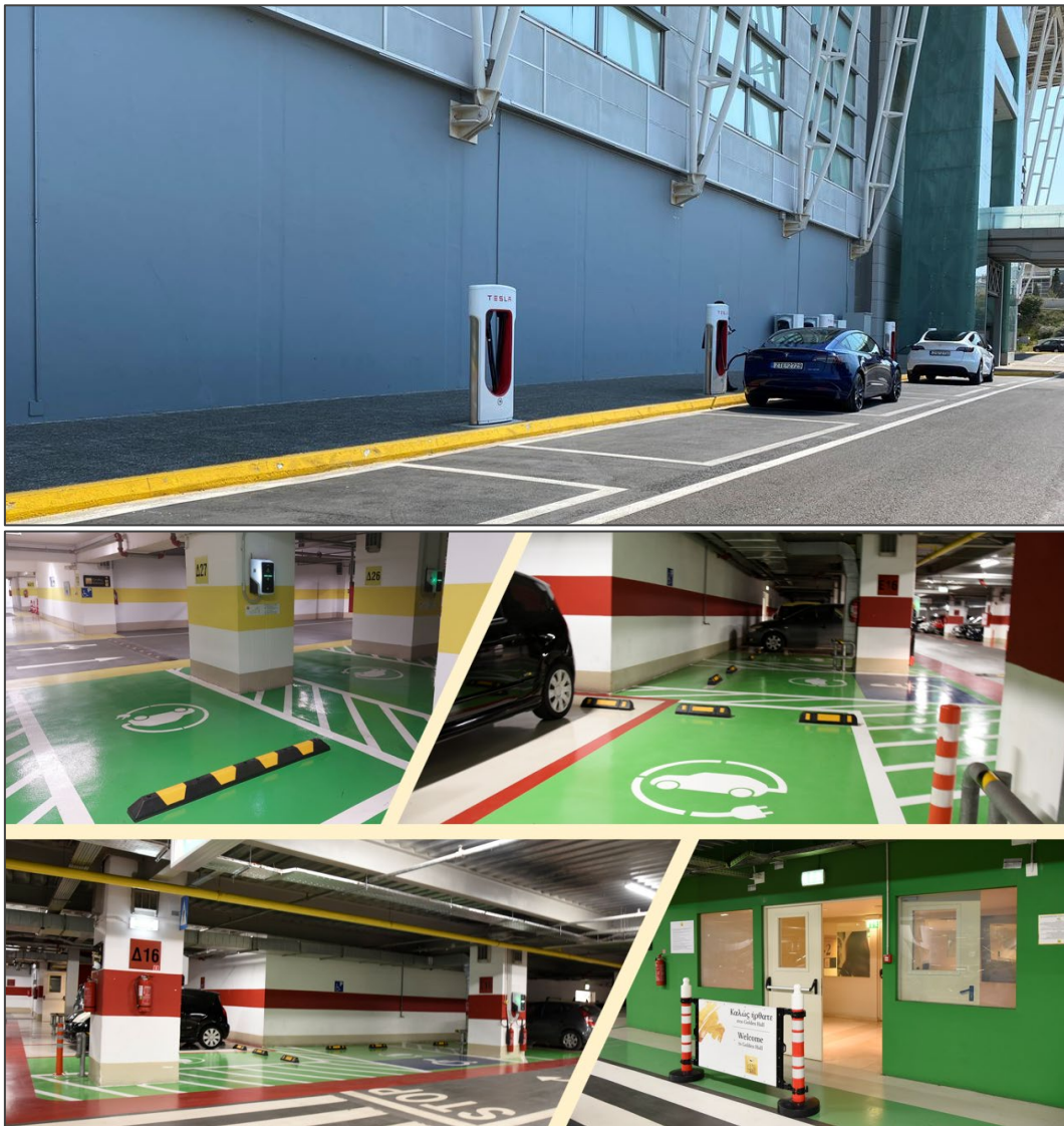
Εικόνα 14: Χώροι φόρτισης ηλεκτρικών αυτοκινήτων
