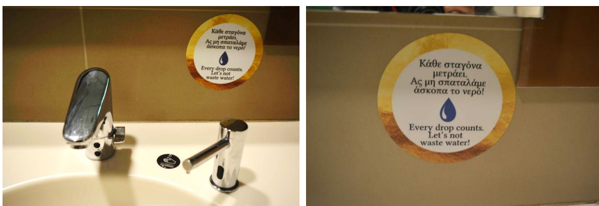
Εικόνα 7: Ενημερωτικές πινακίδες για την εξοικονόμηση νερού και τη χρήση αυτόματου διανομέα υγρού σαπουνιού στα WCs του Ενιαίου Εμπορικού & Επιχειρηματικού Συγκροτήματος Golden Hall
