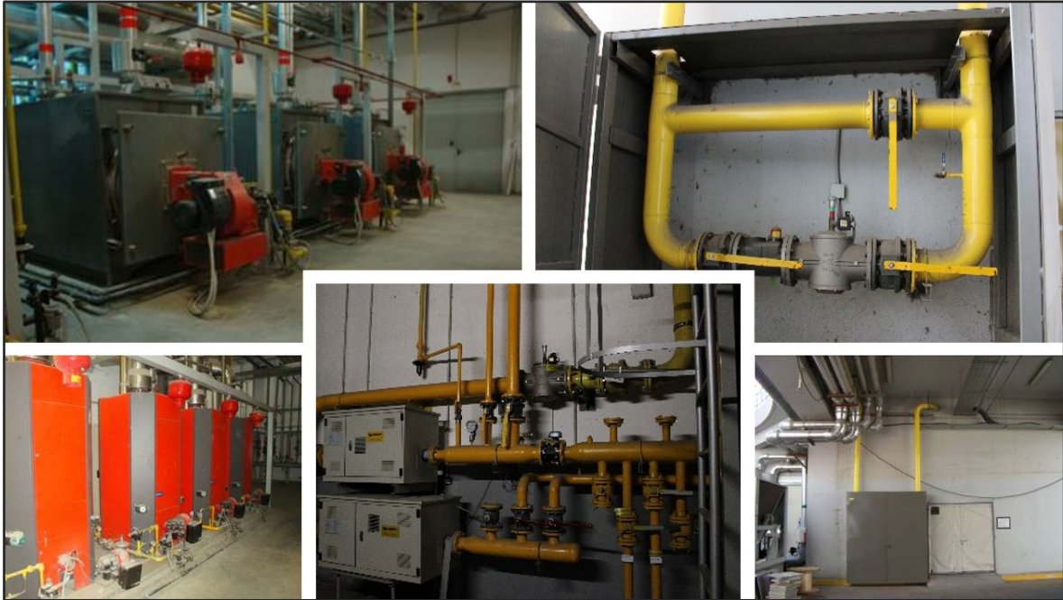
Εικόνα 10: Εγκαταστάσεις φυσικού αερίου στο Ενιαίο Εμπορικό & Επιχειρηματικό Συγκρότημα Golden Hall
