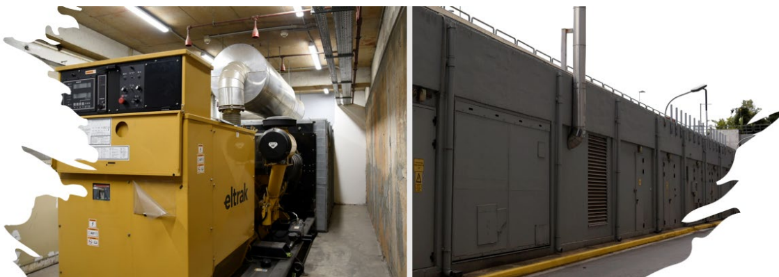
Εικόνα 11: Εφεδρικό Η/Ζ (γεννήτρια) που τροφοδοτεί το συγκρότημα σε περίπτωση απώλειας ισχύος
