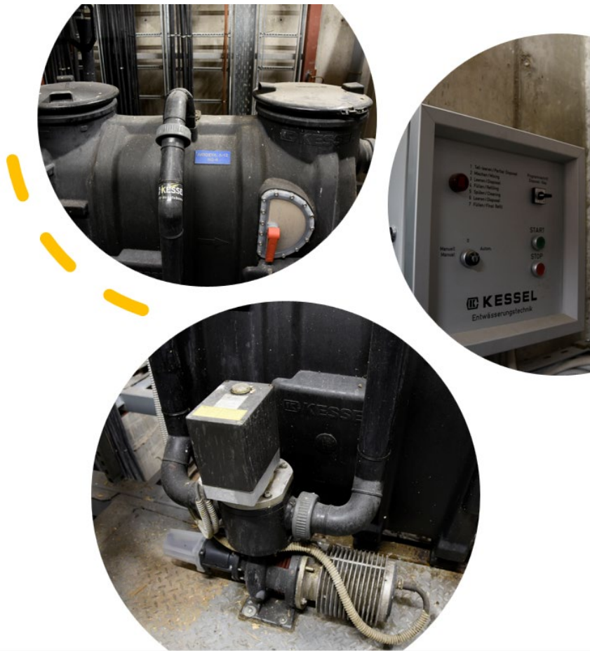
Εικόνα 9: Λιποσυλλέκτης για τη διοχέτευση των υγρών αποβλήτων στο Ενιαίο Εμπορικό & Επιχειρηματικό Συγκρότημα Golden Hall
